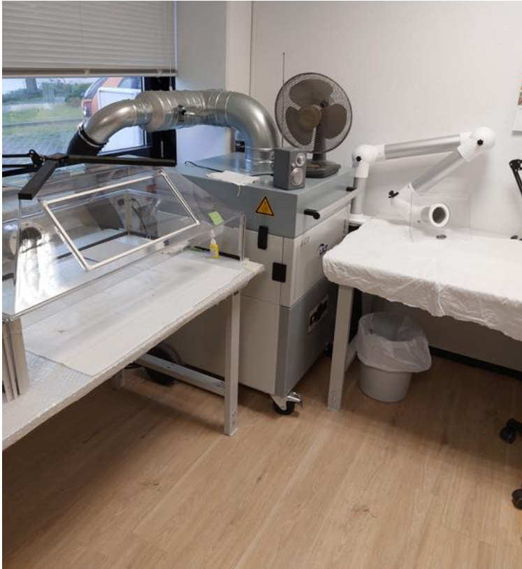
Bild 3: Zentrale Filteranlage ACD 1200 mit angeschlossenen Erfassungselementen
