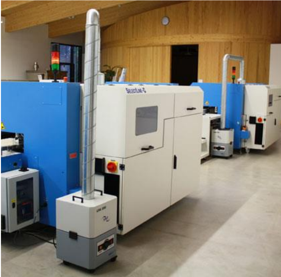
Bild 3: Absauganlagen vom Typ LRA 200 mit flexibler Verrohrung an den SEHO-Lötanlagen
