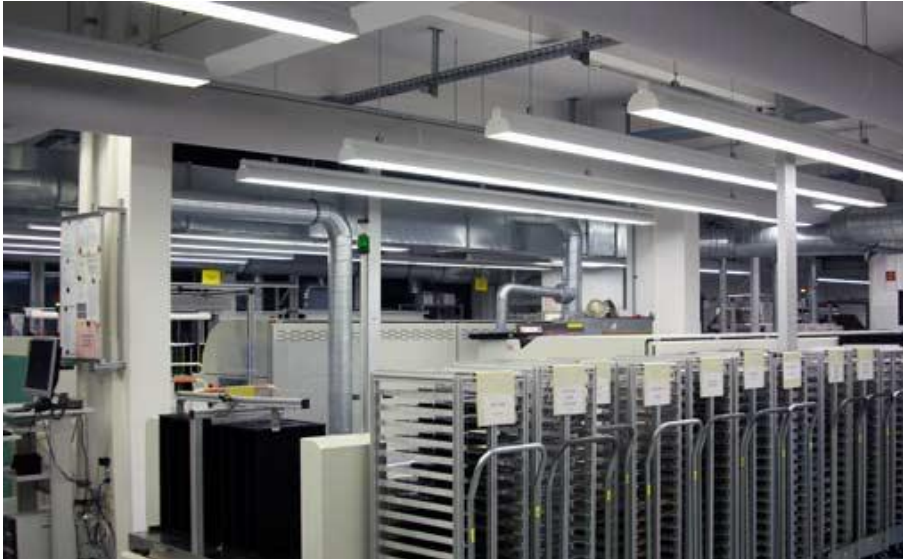
Bild 4: Hallenabsaugung im Trocknungs- und Lagerbereich
