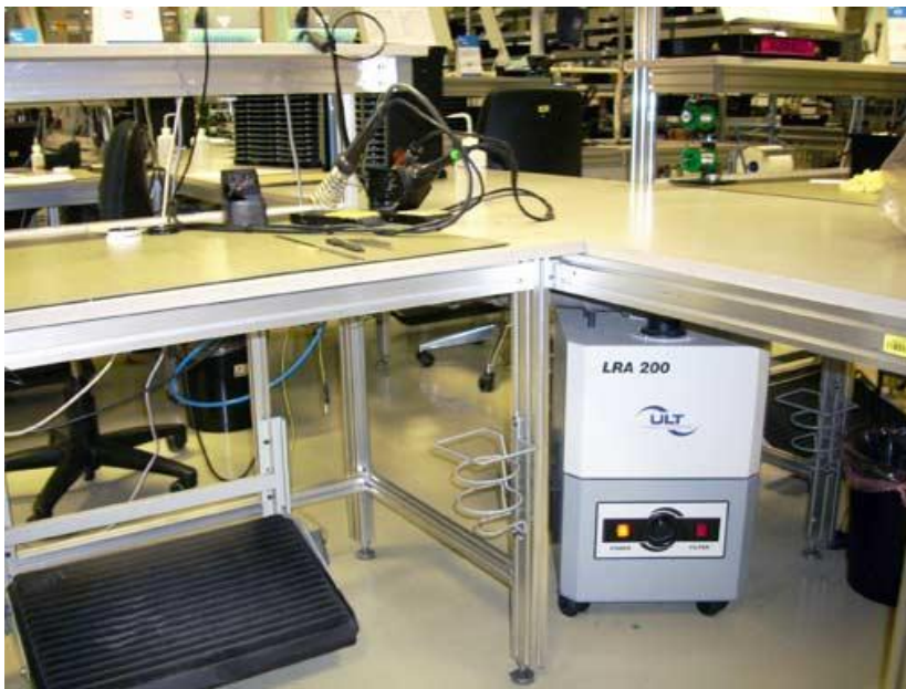
Bild 1: Absaug- und Filtergerät LRA 200 an Handlötarbeitsplatz
