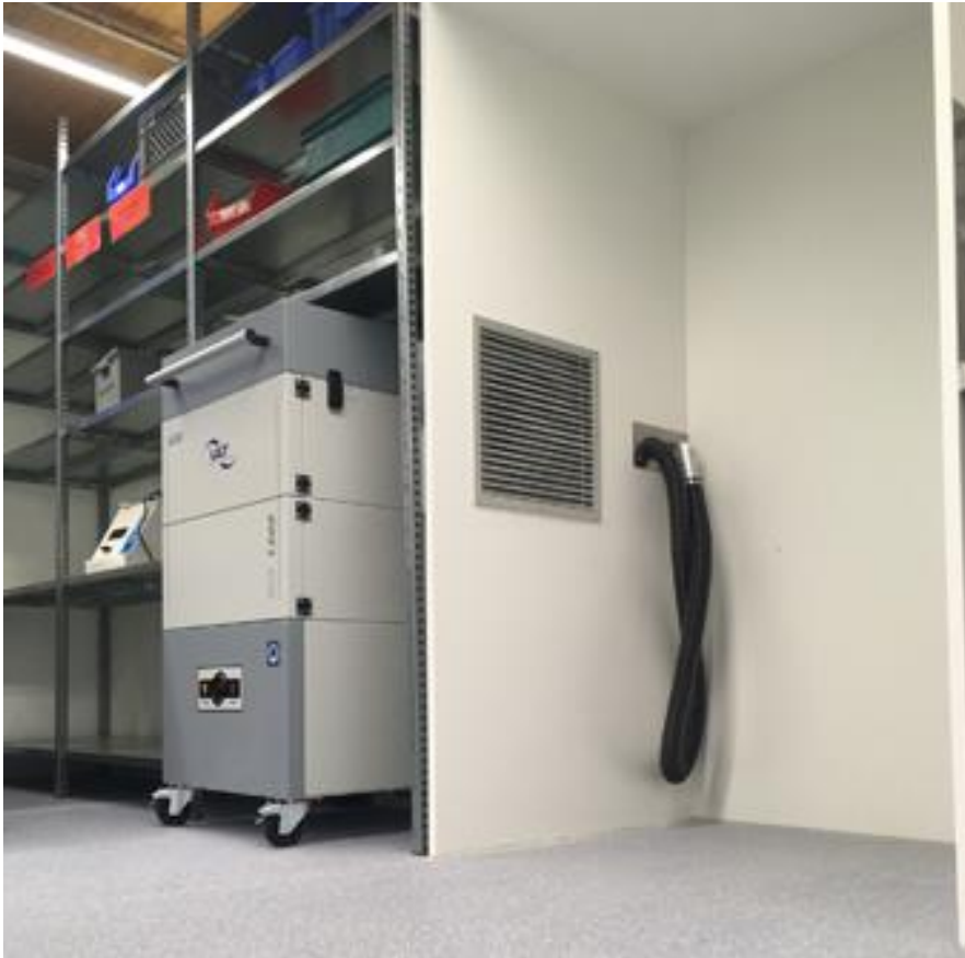
Bild 3: Absauganlage links neben der Reinigungskabine
