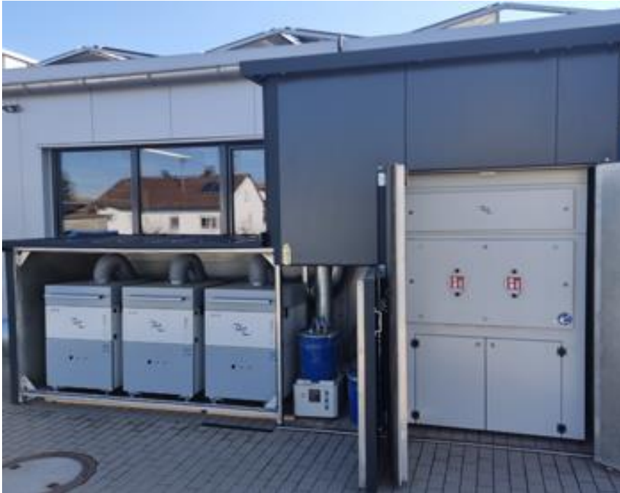
Bild 3: Absauganlagen LAS 2000 (rechts) und ACD 1200 – geschützt vor Witterungseinflüssen
